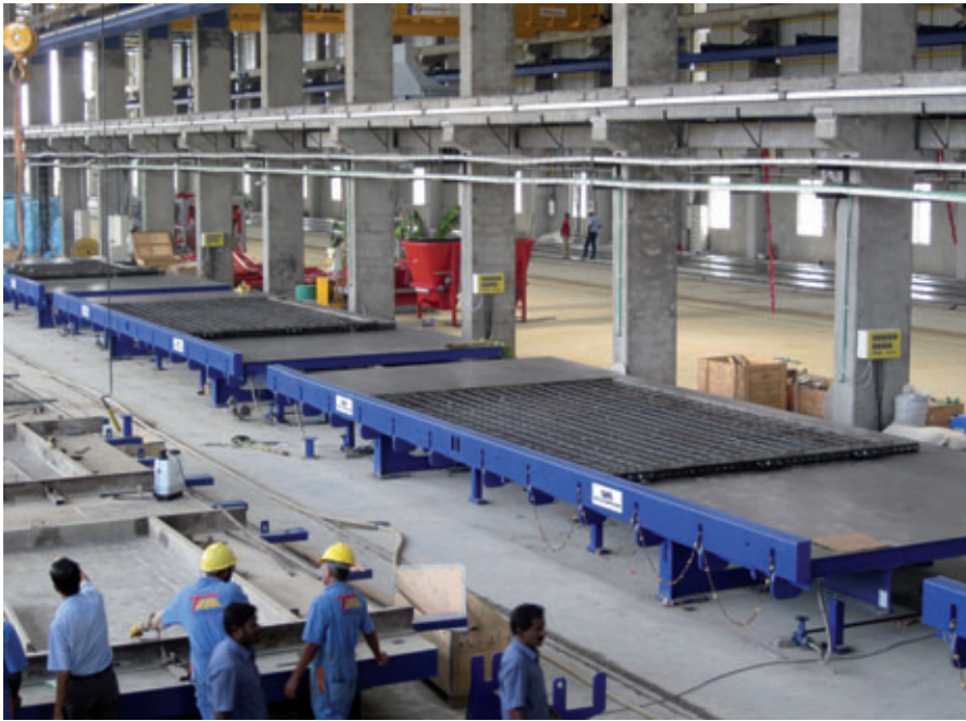
Vier Kipptische mit den Maßen 4,5 m x 12,5 m aus hochpräzisen einteiligen Stahlblechen für optimale Sichtbetonoberflächen der Fertigteile
