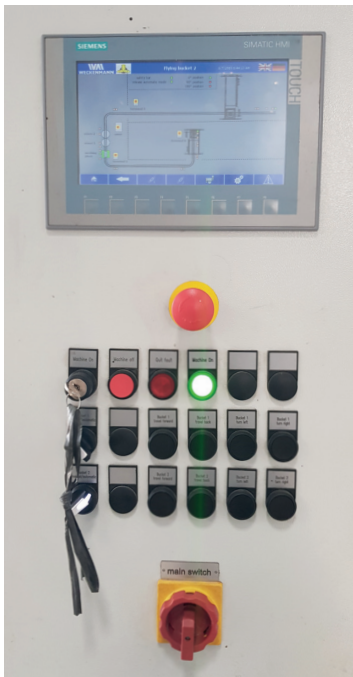
Панель управления коммуникационной системы для запроса бетонной смеси с визуализацией процесса
