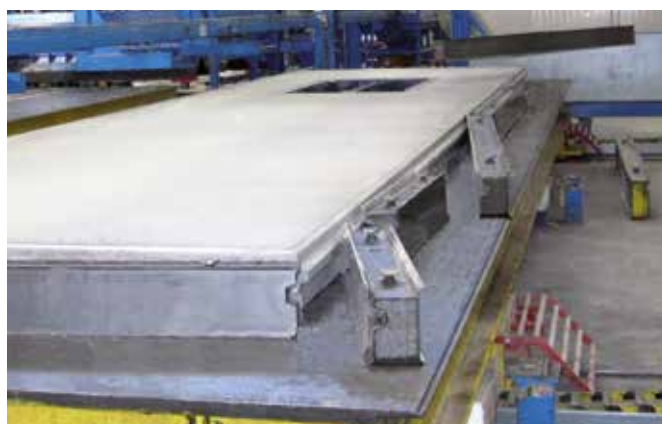
Изготовление массивного стенового элемента с фасками и стыками с использованием опалубки серии М.
