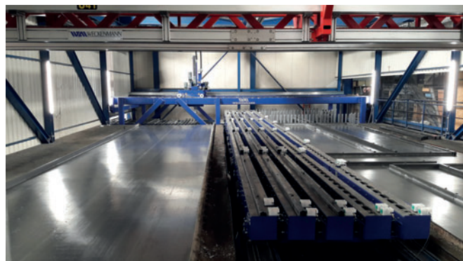
Depois da modernização: Instalação de moldagem com novos transportadores de rolos apalpadores e novo carregador Weckenmann
